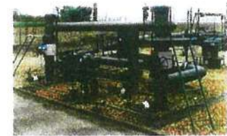
Poste de sectionnement aérien
